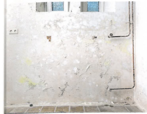
In den Kellerbereich war Feuchtigkeit eingedrungen: Deutlich sind Salzausblühungen zu sehen.
